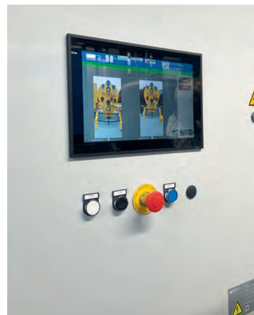
In de technische ruimte springt de ETT 1264 in het oog; een 12,1 inch multi-touch besturingspaneel met Edge3 processor en OPC/UA-communicatie.
