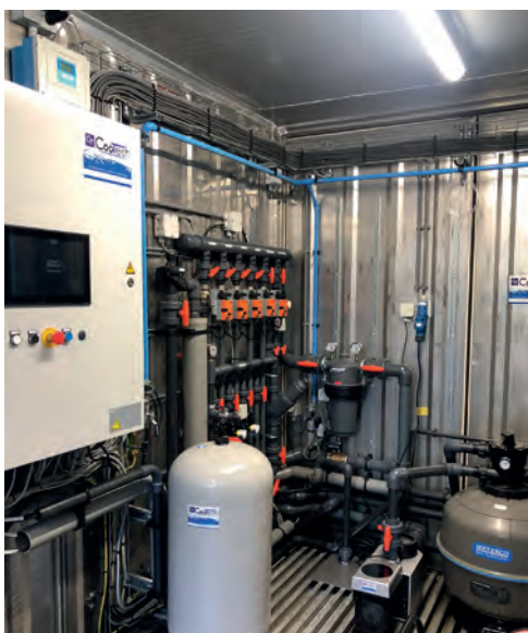
In de achterste hoek van de Blauwe Watertuin vinden we de container, waar pompunits, buffervaten, waterontharder, kleppensysteem en uiteraard ook de besturing is te vinden zijn.
